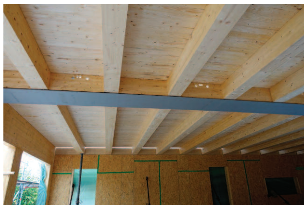
Fot. 4. Strop żebrowy, zespolony drewniano-betonowy na belkach Hybridbeam® w szkole w Ahlten (Niemcy)
