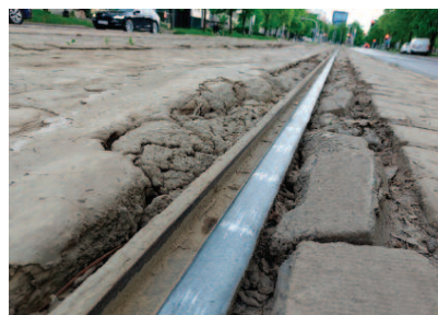
Photo 2. Collapse of stone cubes in the track area, Powstańców Śląskich Street (04/2024) Fot. 2. Zapadnięcia kostki kamiennej w pasie torowiska, ul. Powstańców Śląskich (04.2024 r.)
