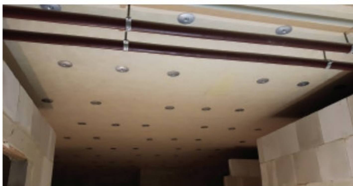
Sufit w garażu podziemnym, w którym jako izolację zastosowano płyty ISOVER Stropmax 31
