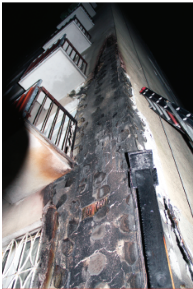
System ociepleń wykorzystujący styropian samogasnący stosowany do ocieplania budynku średniowysokiego z pewnością uzyskał klasyfikację NRO, ale w konkretnych rzeczywistych warunkach rozprzestrzenił ogień (pożar budynku mieszkalnego w Warszawie przy ul. Jaktorowskiej, 2011 r.) Fot. ROCKWOOL
