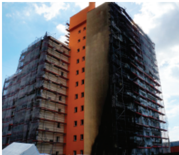
Fasada budynku wielorodzinnego w Bytomiu po pożarze (24 czerwca 2014 r.)
